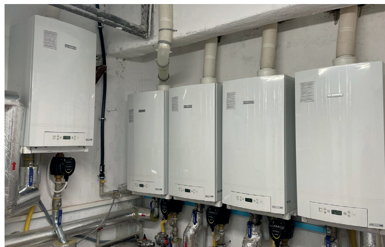
Каскада с 5 котли Condens 5000 W
