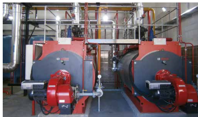
Парни котли UT-L 28 с обща мощност 7 MW
