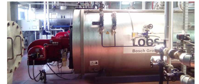
Централа с парни котли със системно управляващо табло SCO
