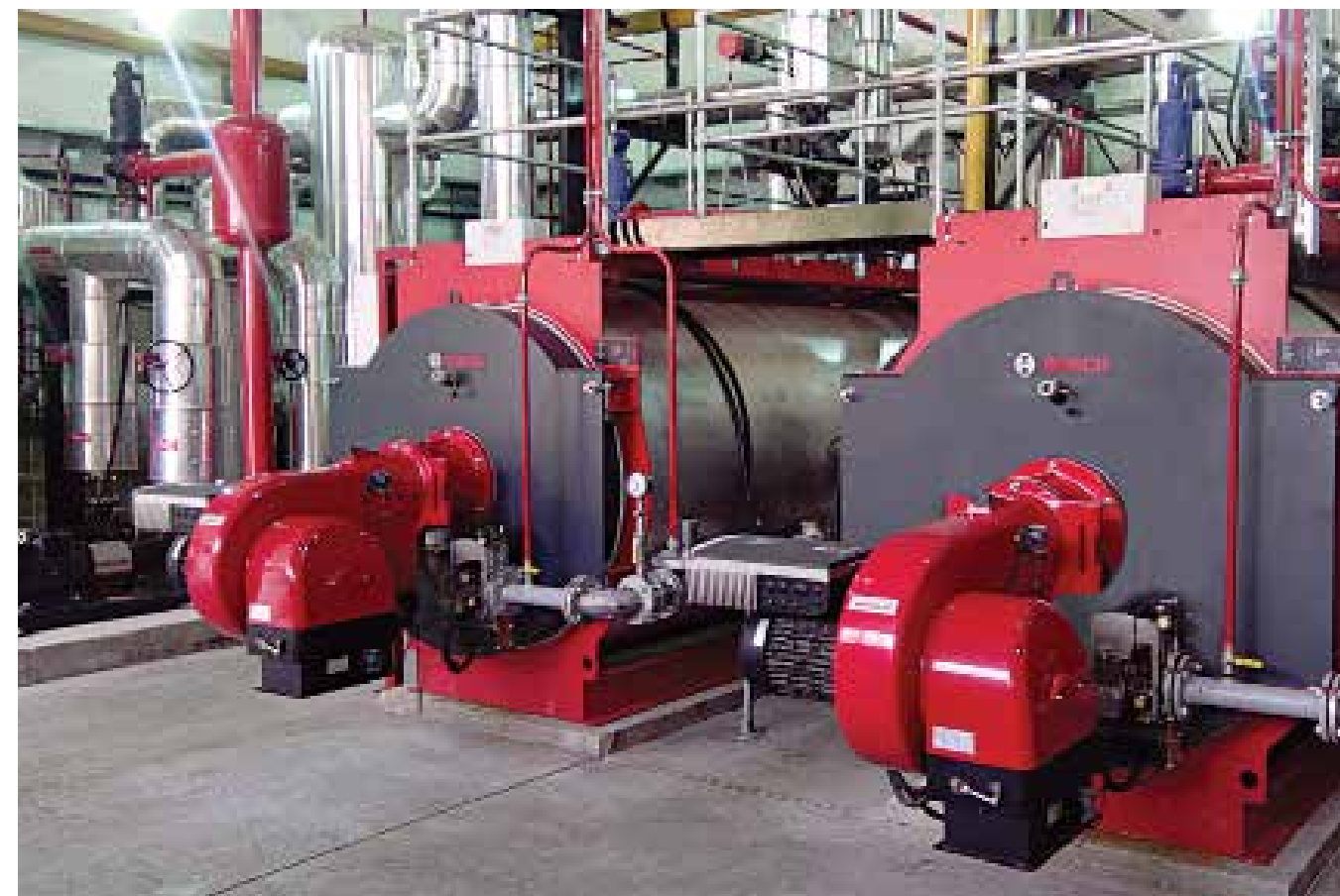
2 отоплителни котела UT-L 28 на газ с интегрирани економайзери
