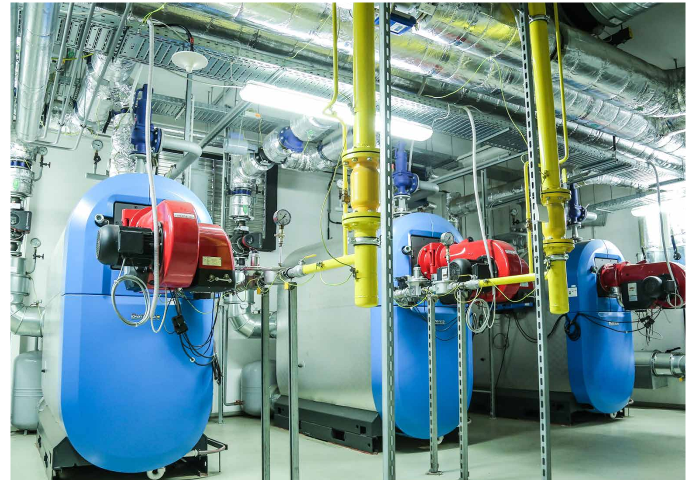
3 кондензни котела Buderus Logano Plus SB745/1200kW, монтирани в котелното помещение на централния офис на Bosch в Будапеща
