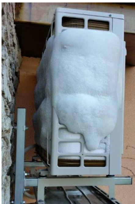
Tepelné čerpadlo se špatným režimem odtávání.
