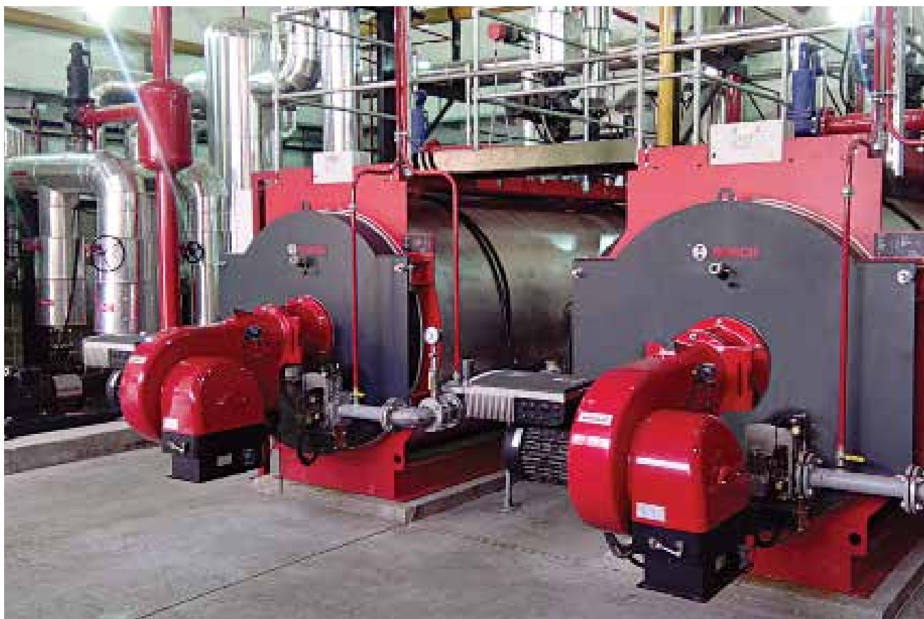
2 toplovodna plinska kotla UT-L 28, s ugrađenim ekonomajzerima
