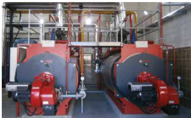
Toplovodni kotlovi UT-L 28, 7 MW ukupnog toplinskog učinka za grijanje
