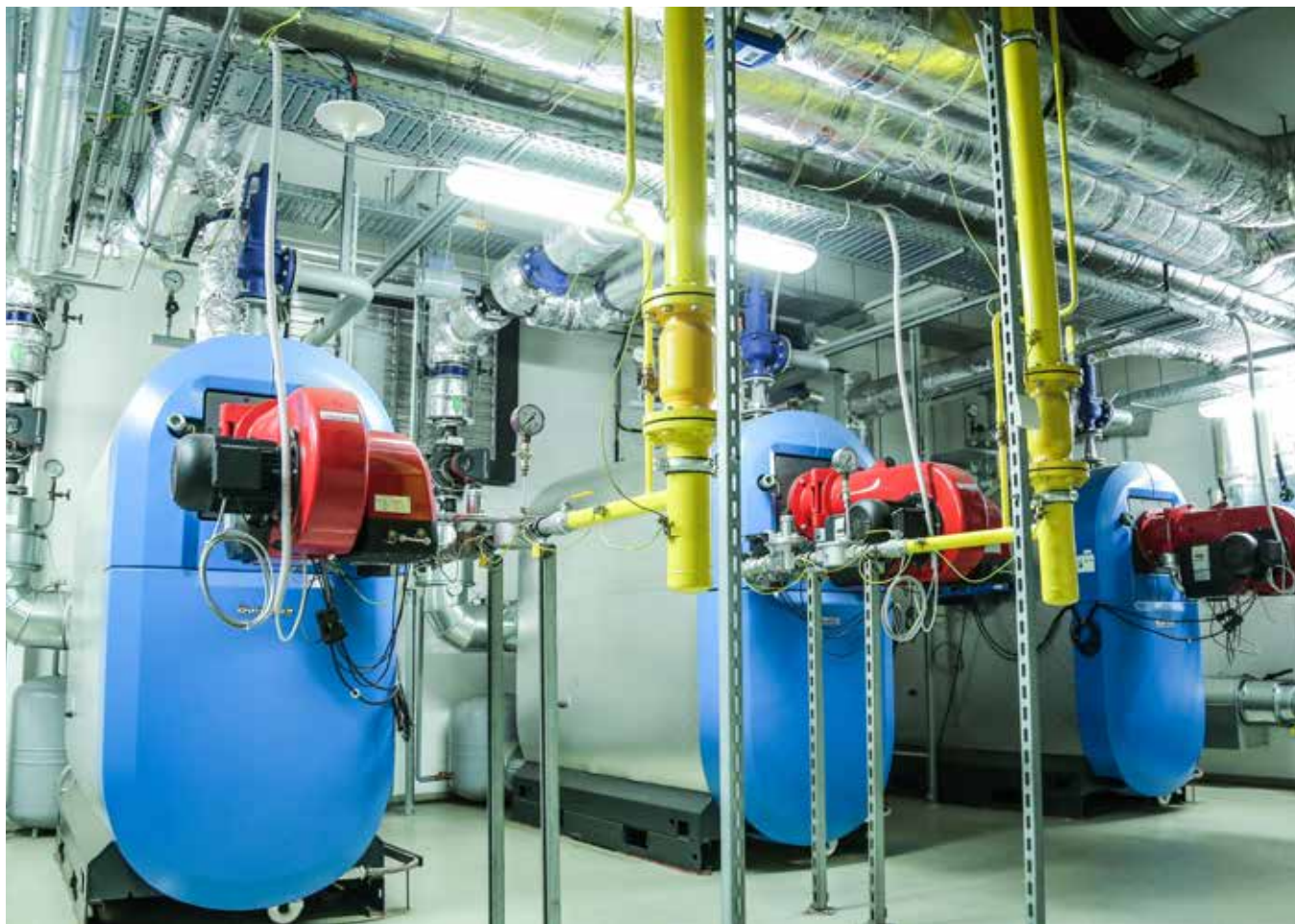
3 Budeus kondenzacijska kotla Logano Plus SB745/1200 kW, instalirana u kotlovnici direkcije Boscha
