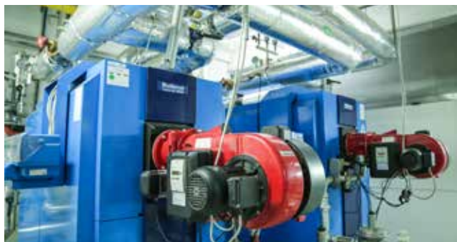
Dva kondenzacijska kotla Buderus Logano Plus SB625/640 kW, instalirana u prvoj fazi
